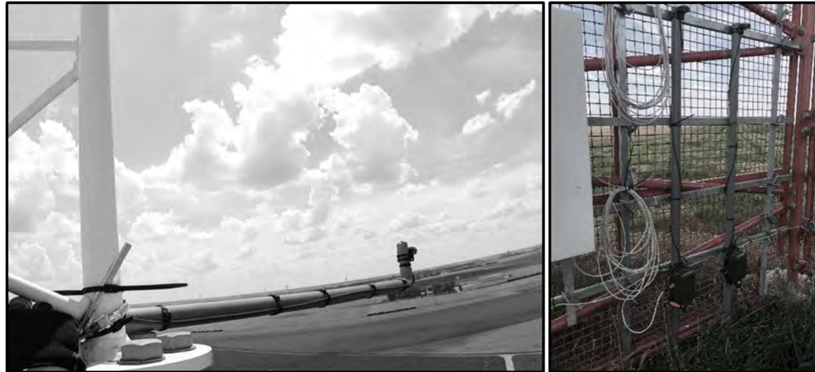
FIGURE 63 – ENREGISTREURS AUTOMATIQUES EQUIPANT LE MAT DE MESURES DU MOULIN D'ÉMANVILLE, SM4BAT FS AVEC MICRO SMM-U2 A DIFFERENTES HAUTEURS (SOURCE : ING ENVIRONNEMENT)
